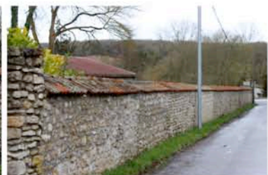
39bis-Leuze Mur début rue des Fontaines
